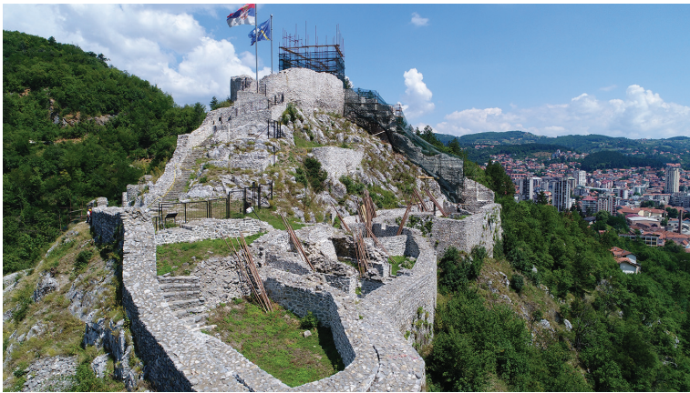
Slika 7: Stari grad u toku izvođenja radova na rekonstrukciji citadele. Dokumentacija Zavoda za zaštitu spomenika kulture u Kraljevu
